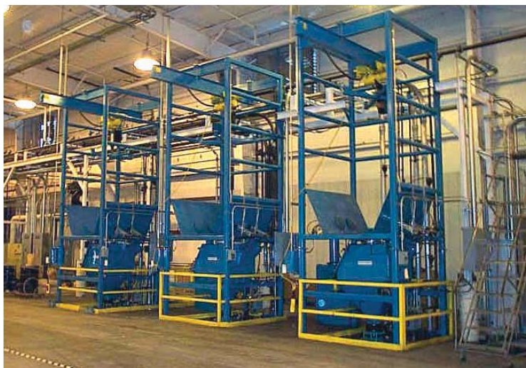
Descarregadores big bags e receptoras de ensacados de negro de fumo, em sistema de transporte múltiplo Full Line Concept™ fase densa.
