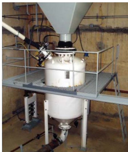
Sistema de transporte pneumático fase densa
