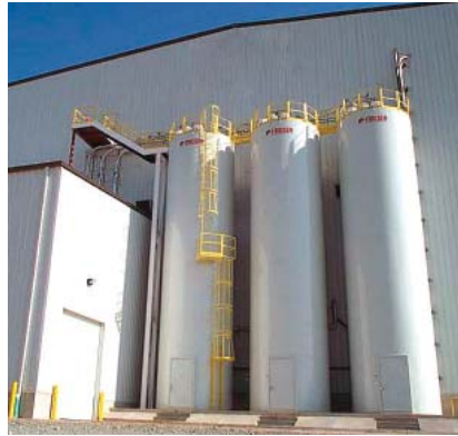
Silos de armazenagem são carregados por um sistema de transporte Full Line Concept™.
