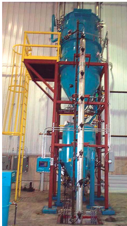
Sistema de transporte Full Line Concept™ de vácuo de alta densidade HDV™, localizado dentro de um galpão para descarga de caminhão
