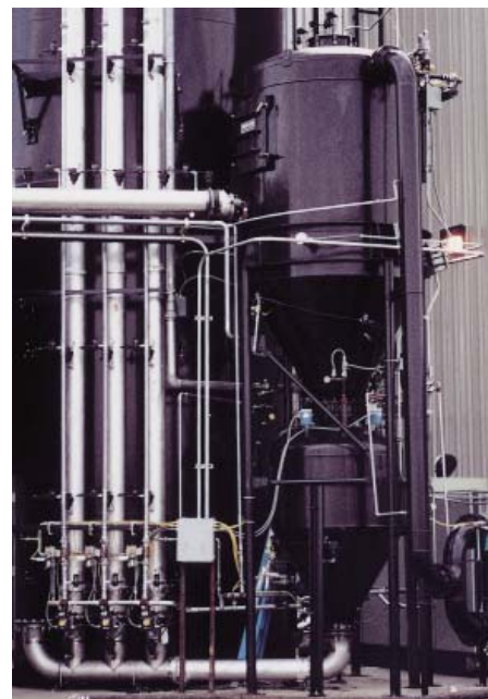
Sistema de vácuo de alta densidade para o transporte de negro de fumo
