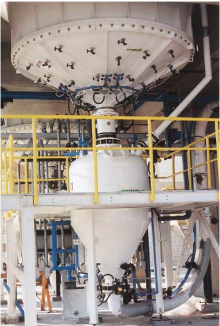
带Vibra-Jet™料仓排料器及用浓相气力发送罐来传输洗涤剂
