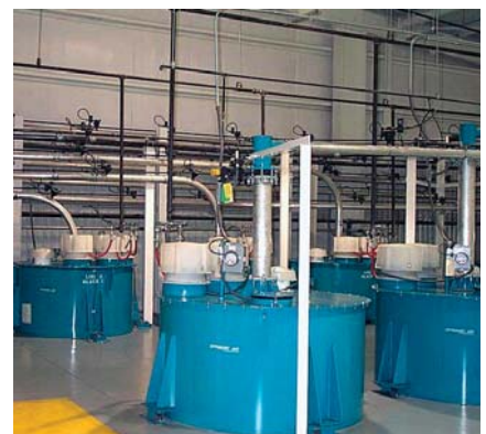
Trémies tampons multiples de 600 litres équipées de filtres Modu-Kleen™ 669
