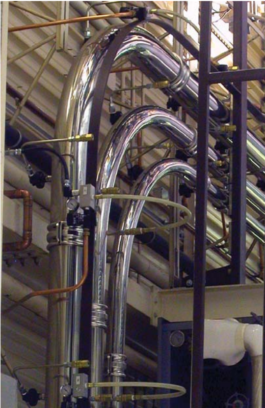
Des canalisations de transport multiples tiennent dans des espaces réduits.
