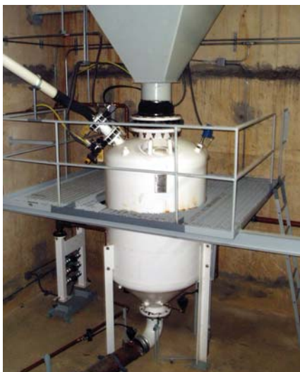
Systèmes de transport pneumatique en phase dense
