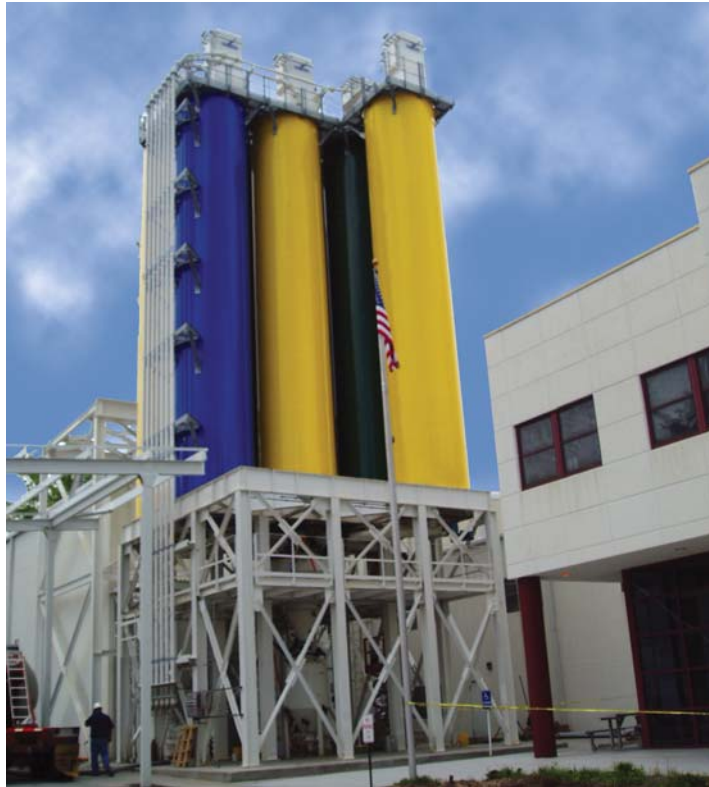
Systèmes complets de stockage, transport, pesage, traitement par lots et mélange - incluant les structures d'acier.
