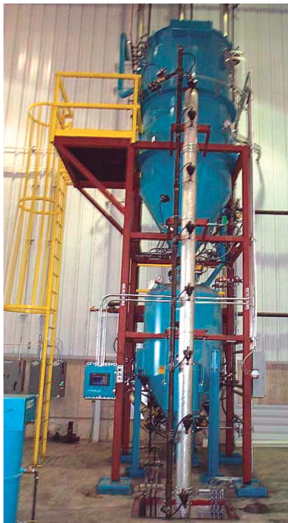
Système de Transport à Haute densité Sous Vide HDV™ suivant le Concept de la Ligne Pleine™ situé dans un bâtiment de déchargement de camion
