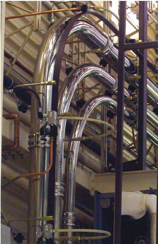
Wiele rurociągów transportowych łatwo pomieścić w ograniczonych przestrzeniach.
