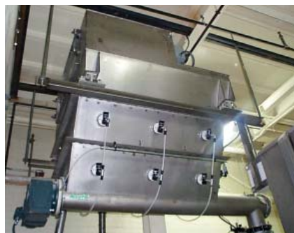
Sistemas de almacenamiento y dosificación.
