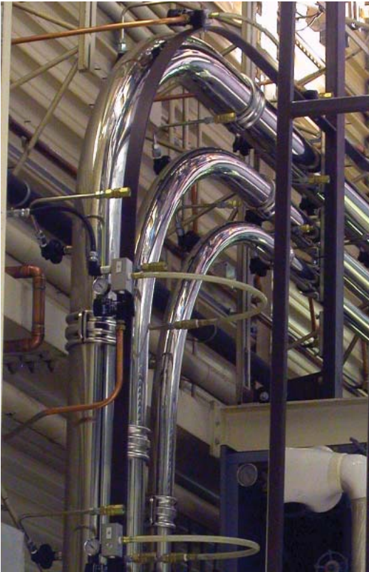
Múltiples tuberías de transporte montadas sin dificultades en espacios reducidos.
