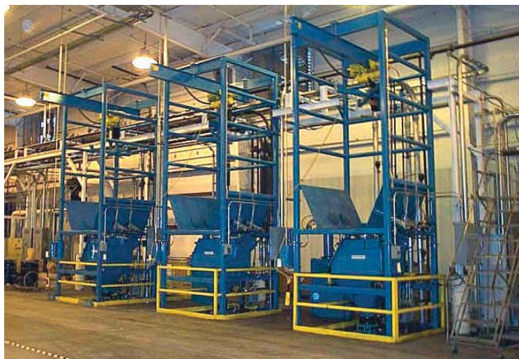
Descargadores de big-bags y sacos de negro de humo en un sistema de transporte múltiple en fase densa según el Concepto de Línea Llena™
