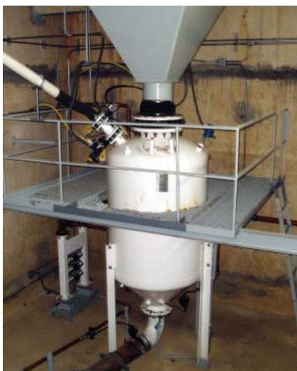
Sistema de transporte neumático en fase densa
