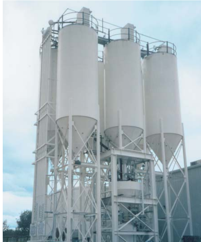
Sistema de pesaje de lotes y transporte que incluye silos y estructura metálica.
